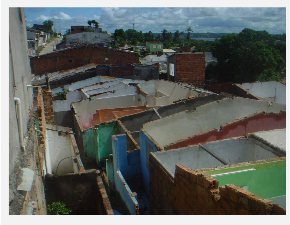
Casas abandonadas sem telhas, portas e janelas no bairro de Bebedouro
